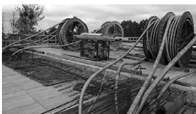
Fot. 3. Przygotowanie kabli w celu przesunięcia rusztowań na kolejny odcinek. Autostrada Obwodnica Wrocławia; obiekt WA20
