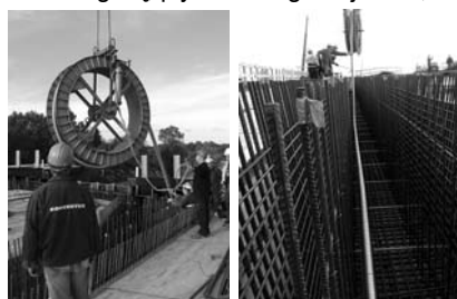
Fot. 1. Układanie prefabrykowanych kabli sprężających na obiekcie WA20 i WA22A' w ciągu Autostradowej Obwodnicy Wrocławia
