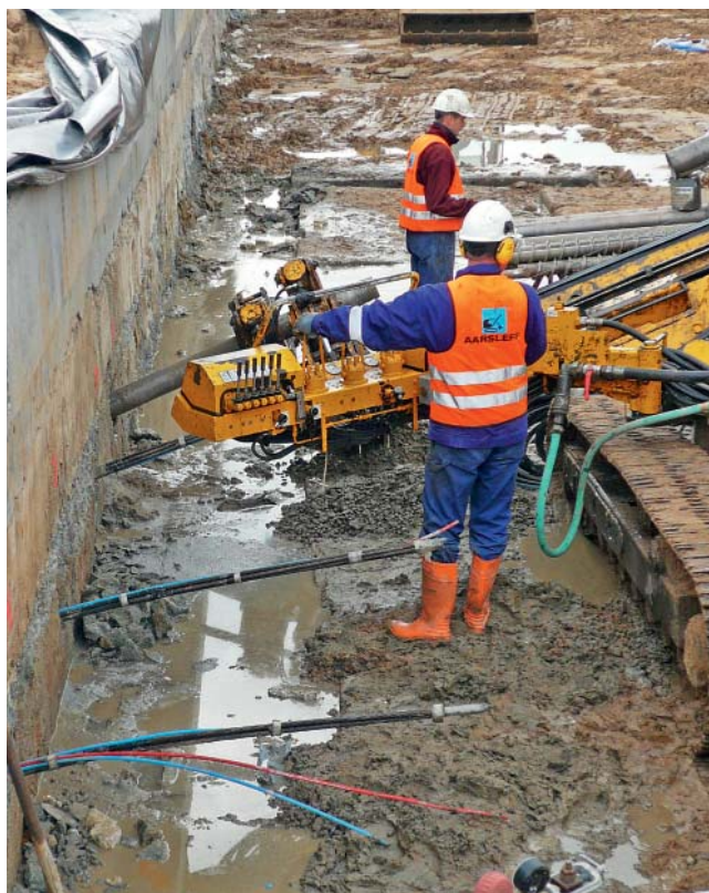
Fot. 4. Wiercenie i montaż kotew linowych SUSPA-DSI na budowie drogi ekspresowej S8 trasa Armii Krajowej
